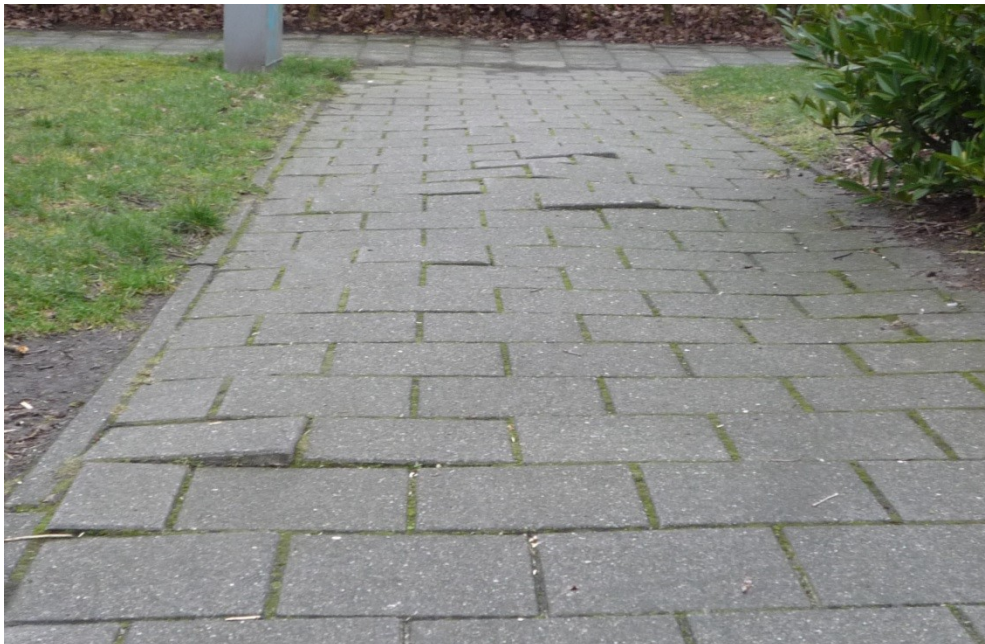
Elementenverharding: Kwaliteitsklasse onvoldoende
