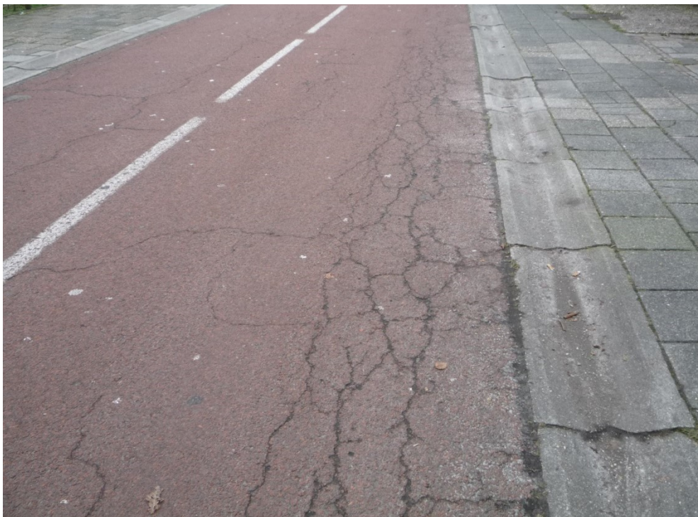
Asfaltverhardingen: Kwaliteitsklasse onvoldoende
